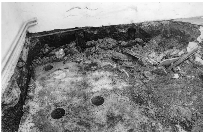
Obr. 1: Propadlá podlaha ložnice na pokleslý zásyp jámy Sklenářka v interiéru budovy
