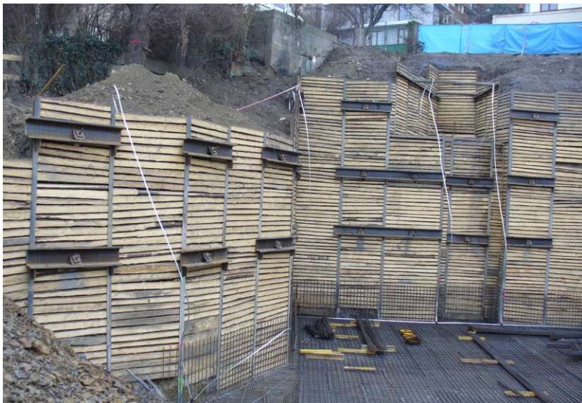
Statické zajištění stavební jámy pro bytový dům „U Plátenice“ Praha 5 pomocí mikrozápor HEB 140 a I 160 kotvených v několika úrovních pomocí tyčových kotev typu Dywidag WR 32 a 26,5, foto: archiv Geoindustrie
