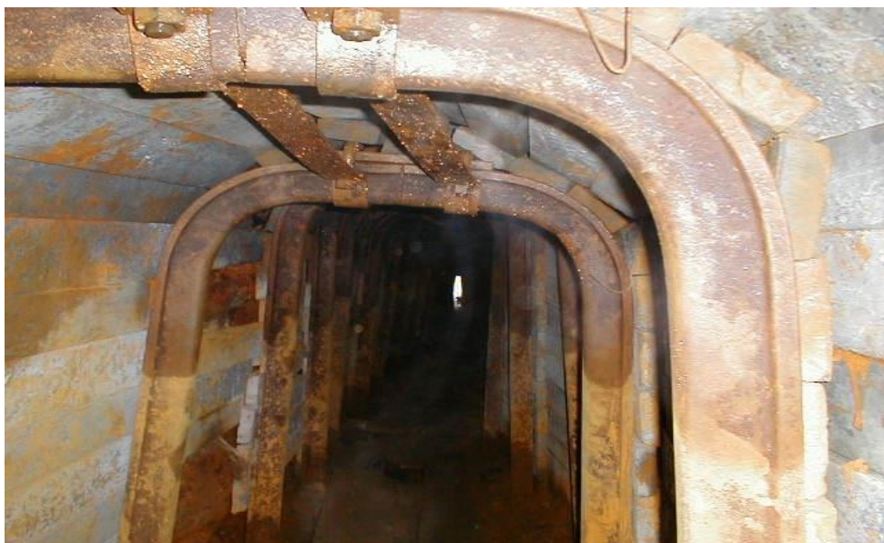
Zajištění havarovaného IV. patra starého grafitového dolu Arnošt, které slouží k odvodnění osmipatrového důlního díla v Českém Krumlově, foto: archiv Timex Zdice s.r.o.
